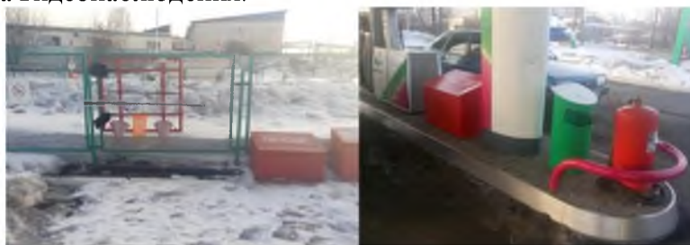
Рис. 1. Средства пожаротушения на АГЗС
