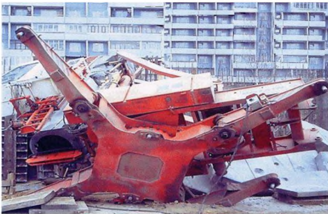
Рис. 3. Аварии башенных кранов, связанных с нарушением правил безопасности работ при их демонтаже
