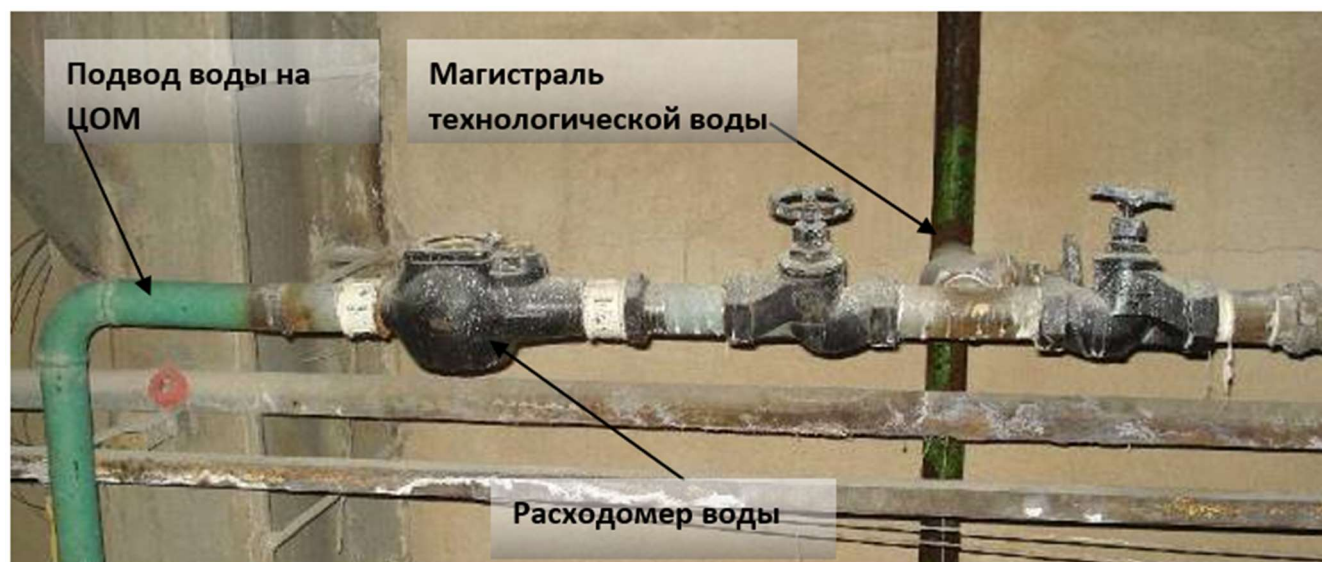
Рисунок 2.8 – Подвод подрешётной воды в отсадочную камеру ЦОМ
