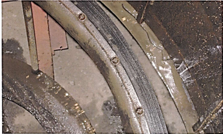
Рисунок 3 – Нижнее вращающееся кольцо гидроуплотнения ЦОМ-5 после окончания стендовых испытаний
