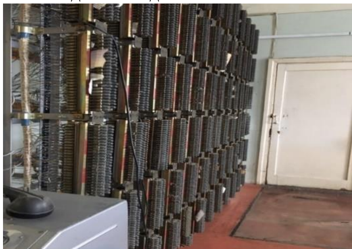
Рисунок 1. Фото типового кроссового оборудования времён СССР.
