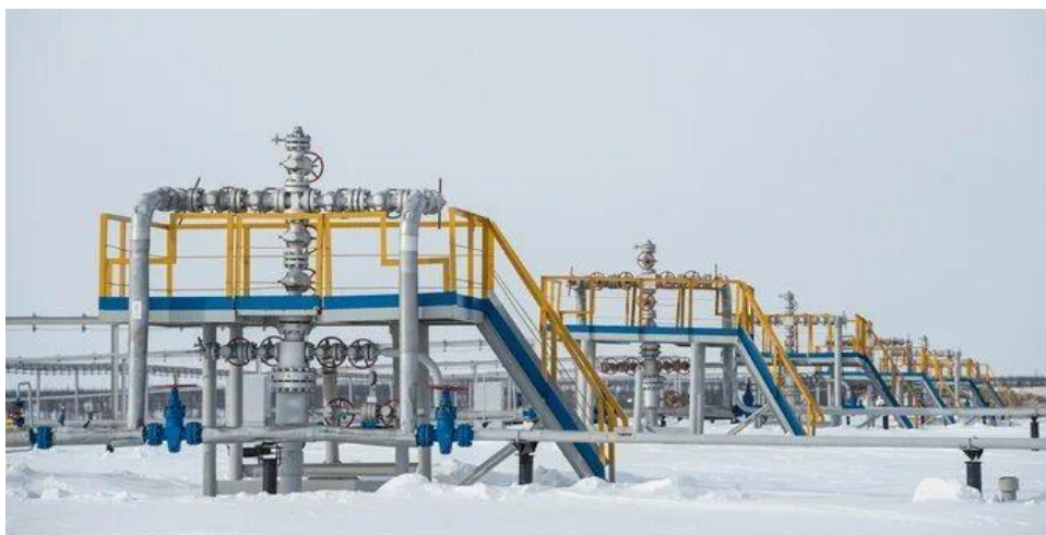
Рисунок 2.2.3 – Объект мониторинга № 1 – газовые скважины
