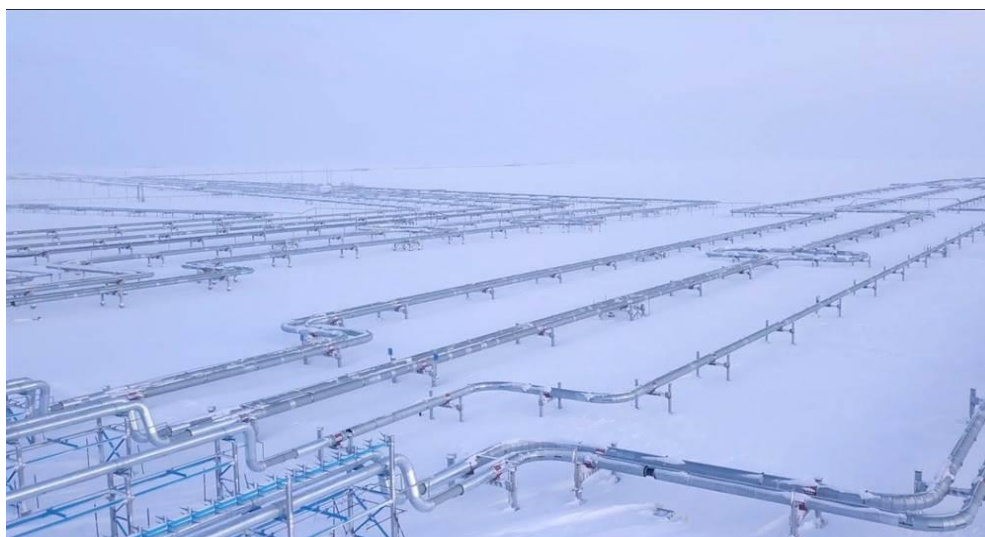
Рисунок 2.2.4 – Объект мониторинга № 2 – газосборный коллектор
