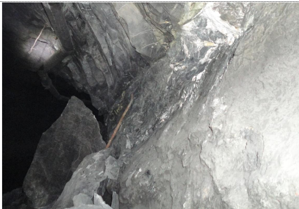
Рисунок 5. Разрушение пород борта штрека по системе трещин и графитизированной зоне рассланцевания.
