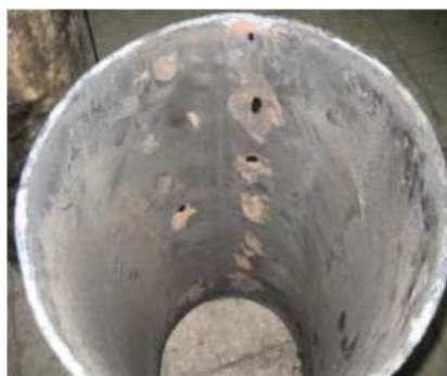
Рис. 6. Пример точечной коррозии
