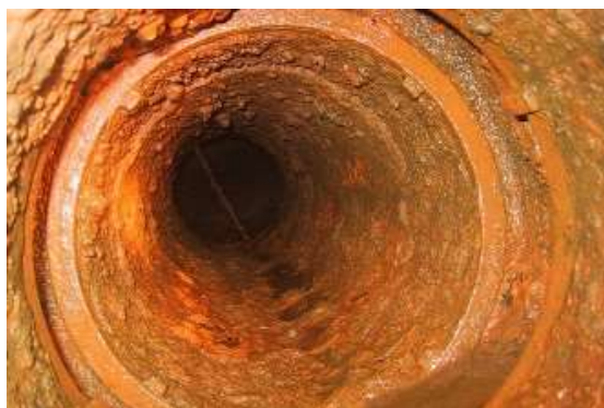
Рис. 1. Коррозия стенок трубопровода
