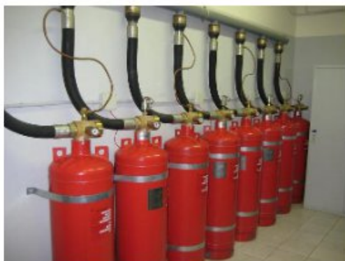
Рис. 16.3. Автоматическая установка газового пожаротушения
