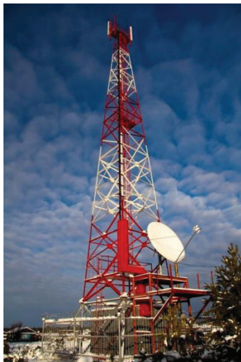
Рис. 1. Базовая станция сотовой связи
